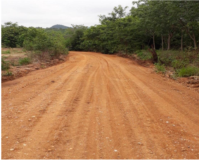
13. ซ่อมแซมถนนเพื่อการเกษตร สายด่านสะแบง หมู่ที่ 3
